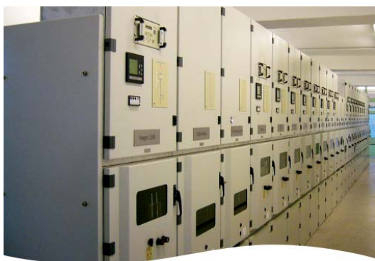
Felújított villamos kapcsolószekrény
